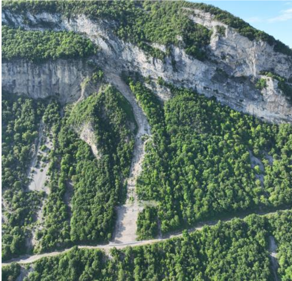
Couloir d'éboulement et de coulées de matériaux
