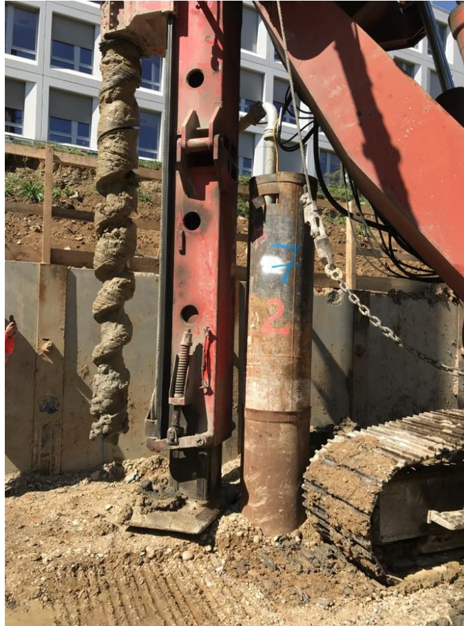
Sous-dimensionnement du dispositif de pompage
