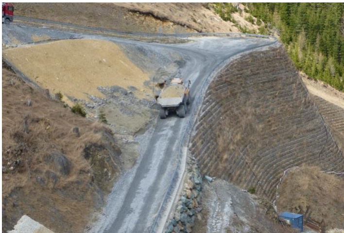
Figure 14 : L'ajout de masses de terre pour élargir la route d'accès a entraîné une augmentation soudaine de la déformation au sein de la structure. © IGMS, TU Graz
