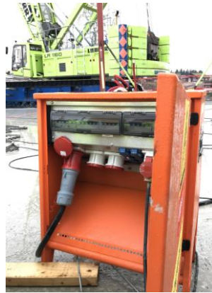
Alimentation électrique via le réseau
