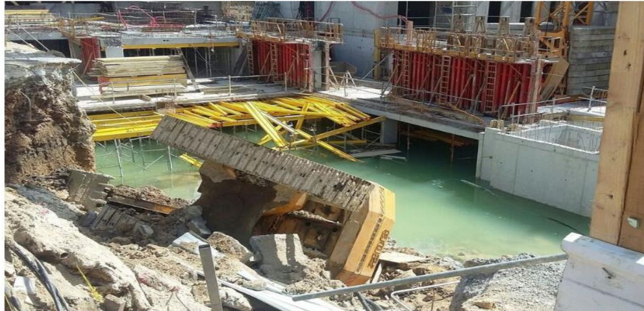
Saint-Rémy-lès-Chevreuse (Yvelines), jeudi dernier. Une pelleteuse est tombée sur le chantier d'un programme immobilier entraînant des dégâts sur la chaussée et la fermeture de la rue de Paris pour plusieurs mois. LP/L. MT.
